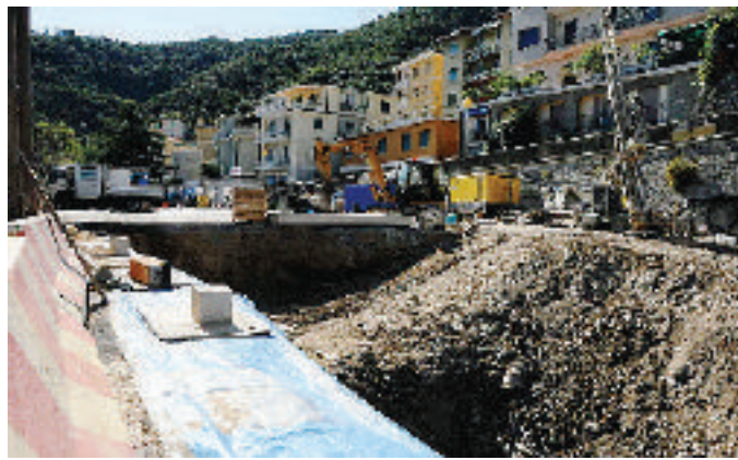
Lavori per i park interrati che hanno provocato lo smottamento
