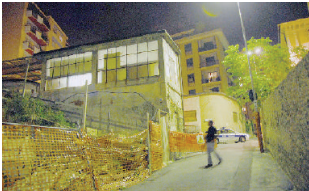
Il vecchio edificio di salita Schienacoste demolito nella notte dopo che ieri aveva dato segni di cedimento
