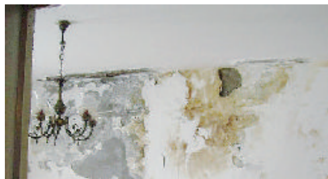
La muffa nell'alloggio di via Giuria
