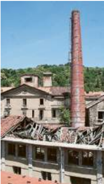
Il tetto crollato della fabbrica
