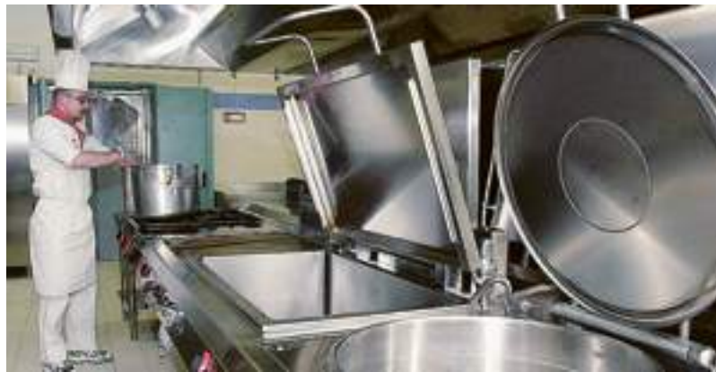
Le cucine attualmente utilizzate nell'ospedale a Valloria
