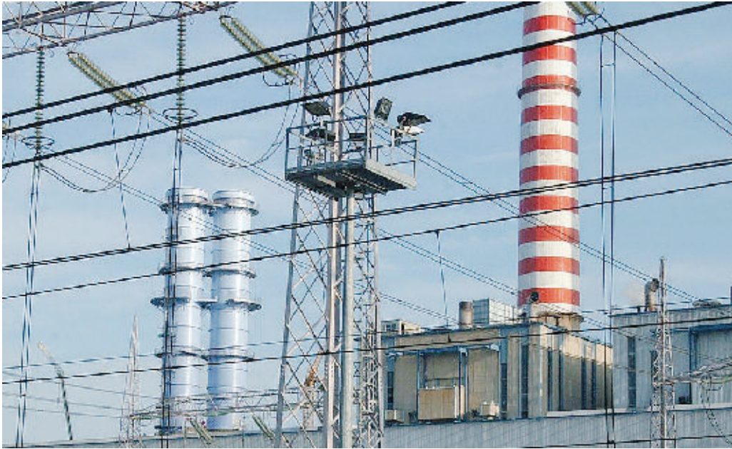
Le linee elettriche della centrale Tirreno Power di Vado Ligure
