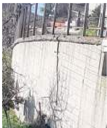
La crepa sul cavalcavia
