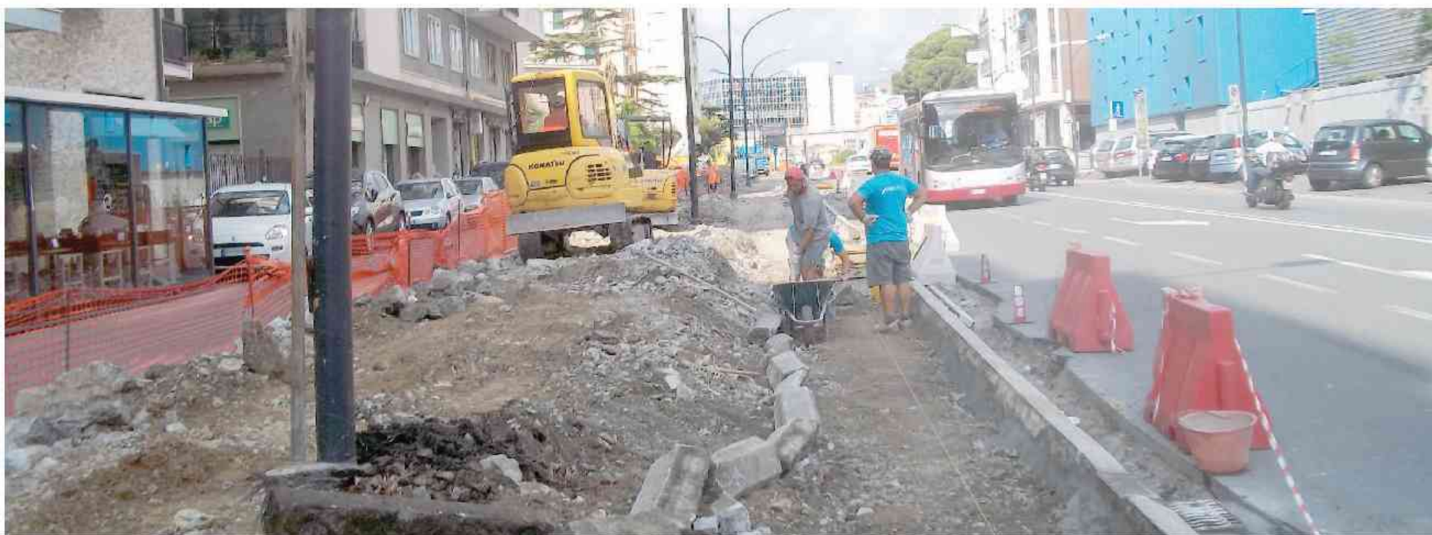
Nel tratto lato mare di corso Tardy e Benech sono stati tagliati 58 pini: le loro radici avevano rotto l'asfalto e reso pericolosa la strada
