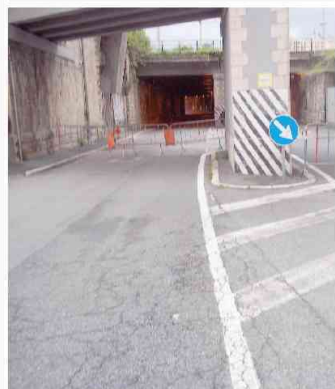
Transenne bloccano l'accesso al tunnel di via Cilea
