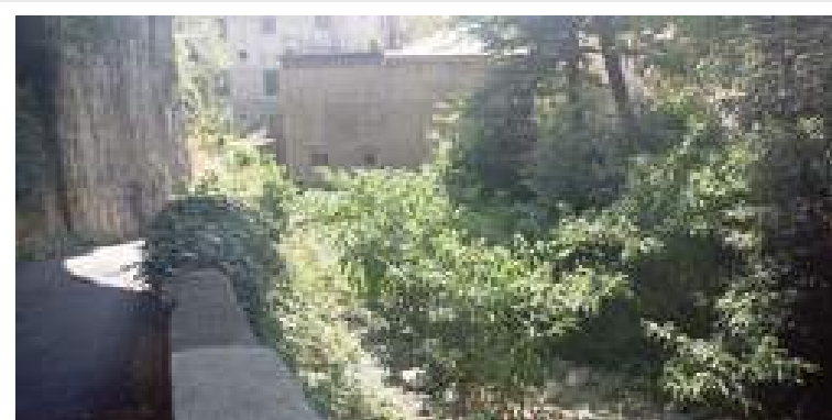
Il rio Lorianò al Santuario non vede un intervento di pulizia da tempo. Il greto è completamente invaso dalla vegetazione
