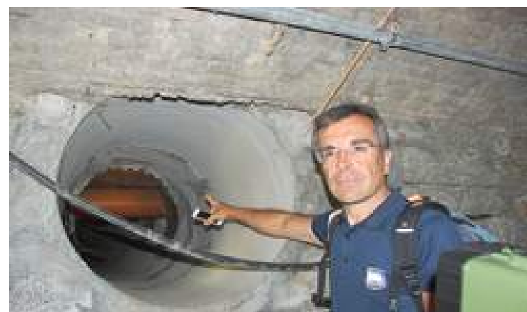
Una delle tubazioni che ostruiscono il passaggio dell'acqua
